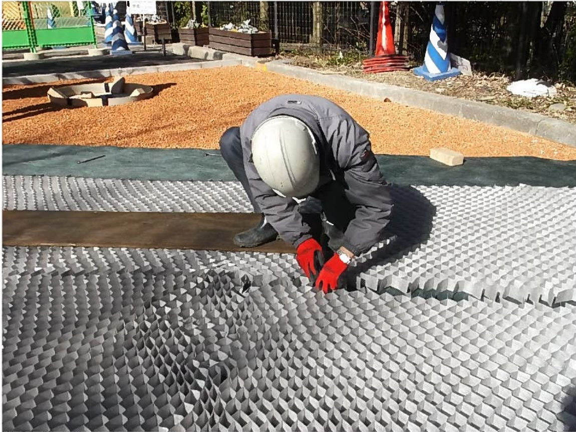
グラウンドグリッド施工 接続をホッチキス 固定をJピンで施工
